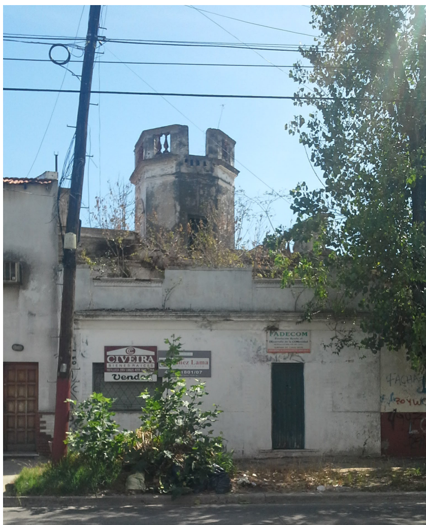
Figura 2: Fachada actual de los restos de la casa con torre. Archivo personal, 10 marzo del 2018.
